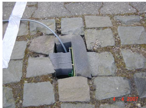
Bild 6-9: Im Boden eingelassener Detektor
